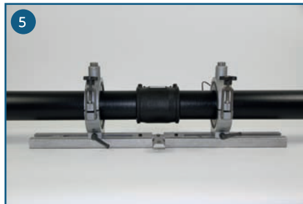
5 Haal de fitting uit de verpakking, schuif de PE buis tot aan de stootrand in de fitting, mocht de PE buis ovaal zijn, gebruik dan de buisklemmen om de PE buis weer rond te krijgen, zodat deze optimaal in de lasfitting past.
