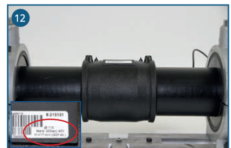
12 De gelaste fitting dient in de buisklemmen af te koelen, ook de koeltijd staat op de fitting aangegeven.
